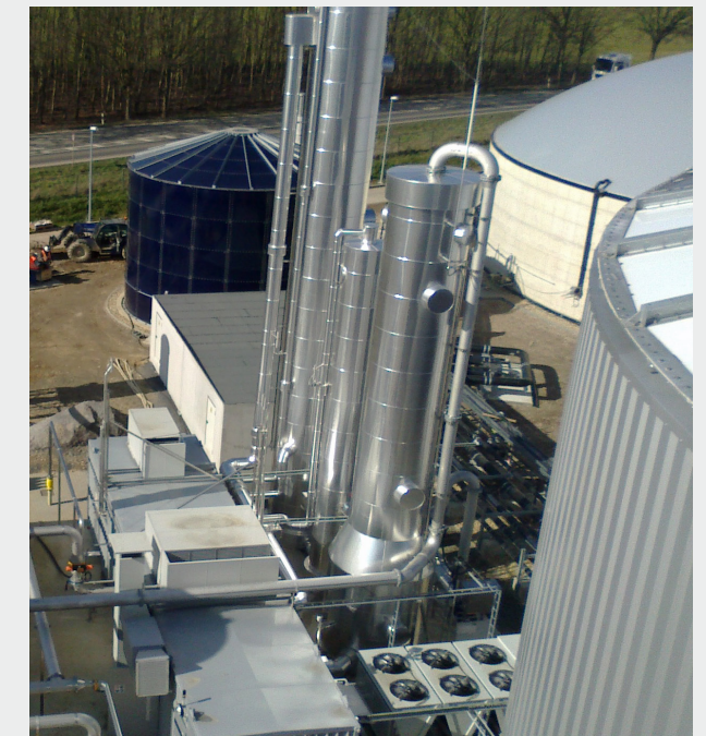
Biogasaufbereitungsanlage nach dem Membranverfahren
