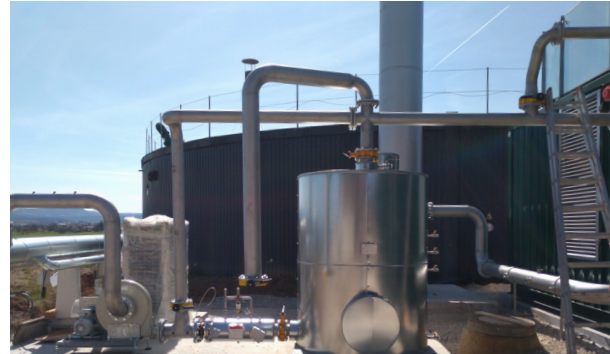
Installation einer Gasaufbereitung
