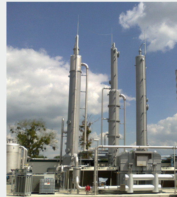
Biogasaufbereitungsanlage nach dem Verfahren der physikalisch-chemischen Wäsche
