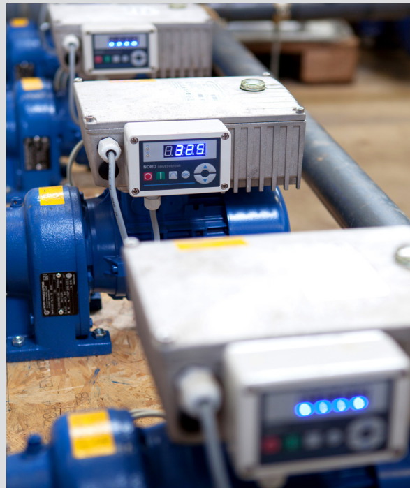
Pumpen mit Frequenzumrichter
