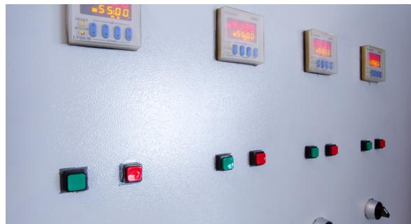
Steuerungsschrank mit Timern und Wählschaltern
