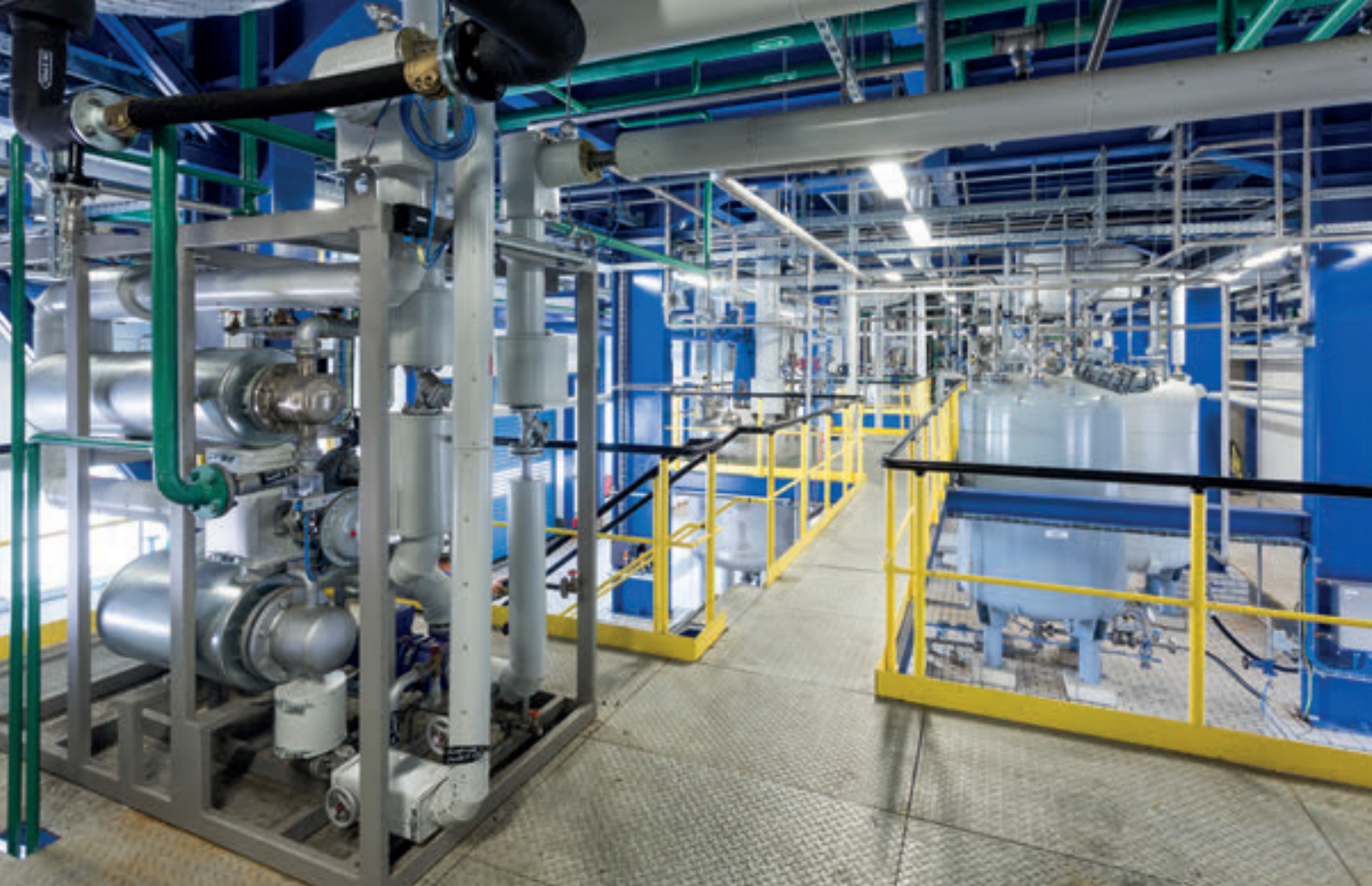
Mehrzwecksyntheseanlage Schirm GmbH, GICON®: Generalplaner
