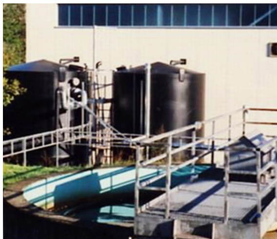
Sickerwasserbehandlungsanlage Deponie Geldern-Pont
