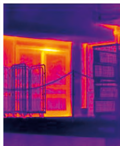
▲ Erstelltes Wärmebild vom Tor im Hinterhof der Wäscherei
