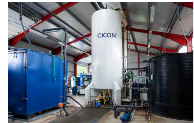
Rieselbettreaktor im standort eigenen Technikum
