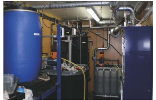
▼ Blick in die Technikumsanlage mit Biogasanlage und reforming unit
